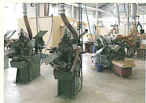
공기를 정화시키는 공장 내 집진시설
